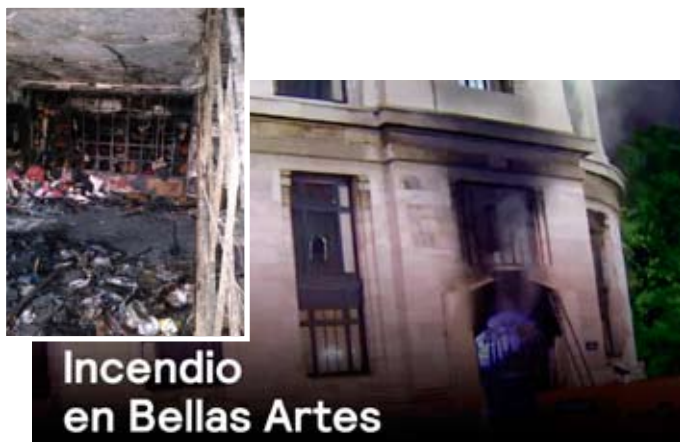
Imagen del “connato” de incendio
